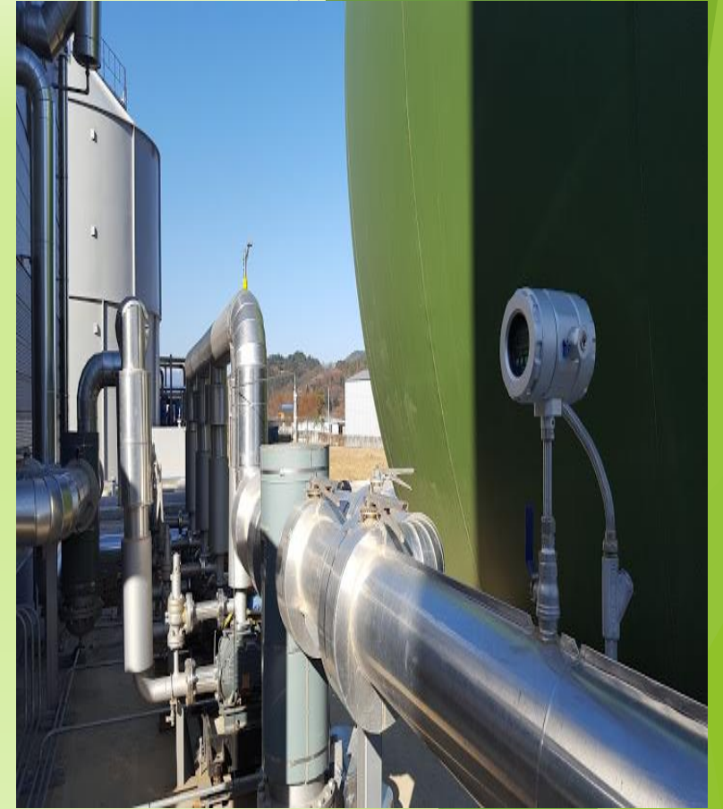
영천 하수슬러지 Bio Gas, 200A 라인 열질량유량계
