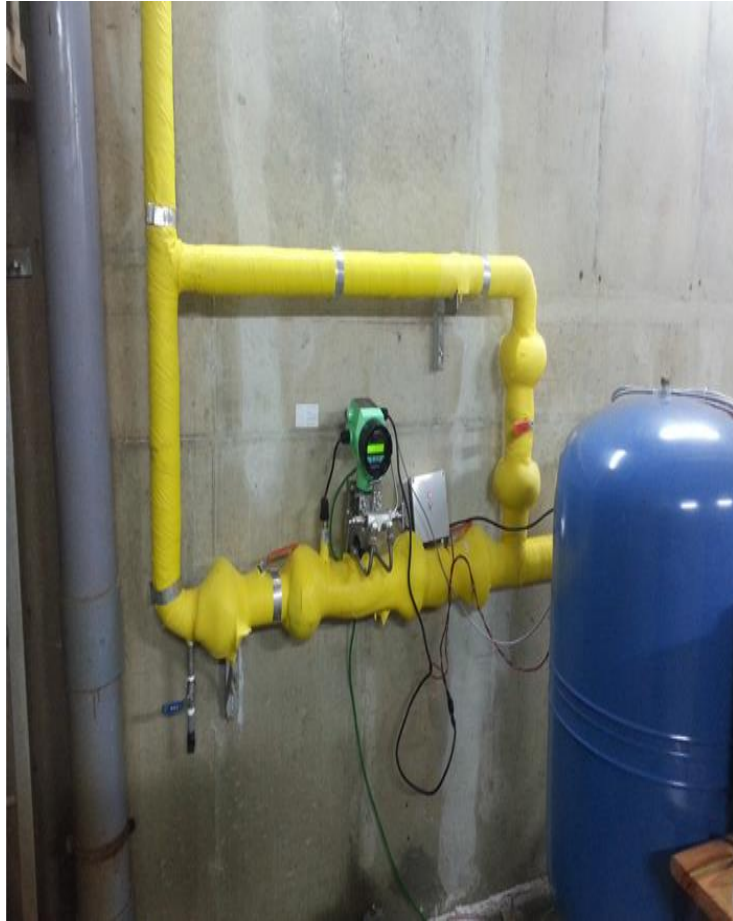
도시철도공사 Water, 50A 라인 FN질량유량계
