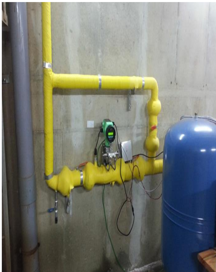
도시철도공사 Water, 50A 라인 FN질량유량계
