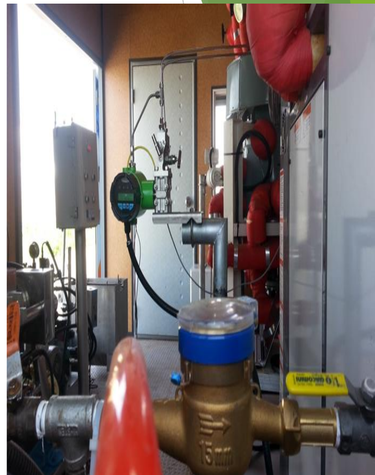
보일러 Water공급, 50A 라인 FN질량유량계
